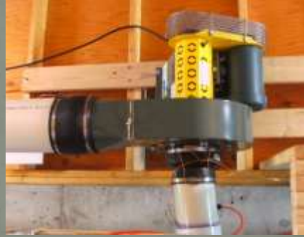
UNH Aeration Fan
